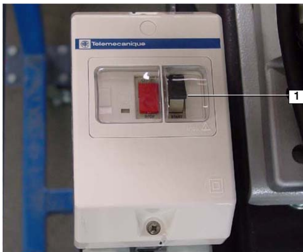
Рис.12. Контактная коробка с автоматом защиты электродвигателя
